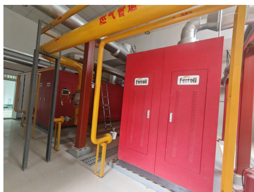
两台燃气锅炉
